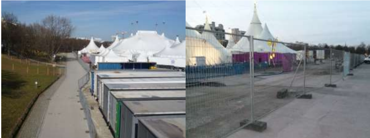
Abb. 5a und 5b: Bauzaunfelder zur Zutrittsverhinderung
