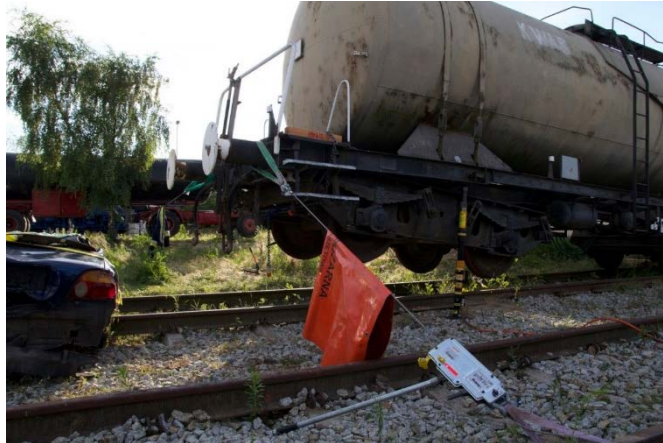
Abbildung 23: Längs gehobenes Schienenfahrzeug mit seitlicher Sicherung durch Mehrzweckzüge 800kg; Quelle Irakli West
