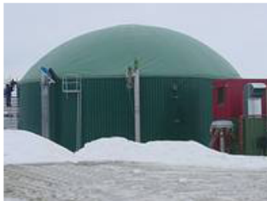
Abbildung 4: Gasspeicher mit Folienspeicher [Quelle: Agrotel]
