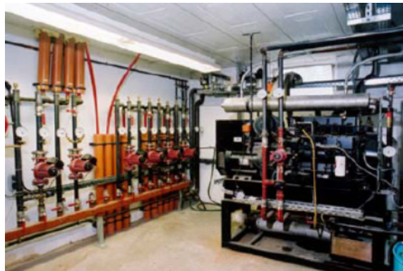
Abbildung 5: Beispiel eines Blockheizkraftwerkes [Quelle Biogas-Nord/ENSPAR Biogas]
