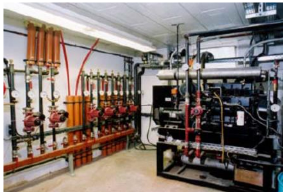
Abbildung 5: Beispiel eines Blockheizkraftwerkes [Quelle Biogas-Nord/ENSPAR Biogas]
