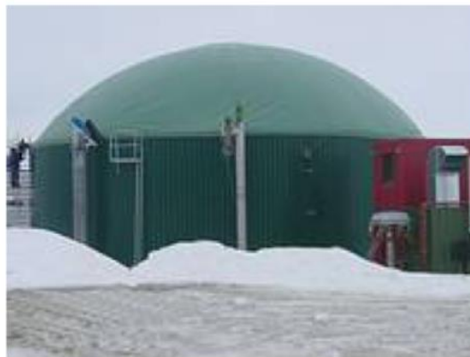
Abbildung 4: Gasspeicher mit Folienspeicher [Quelle: Agrotel]
