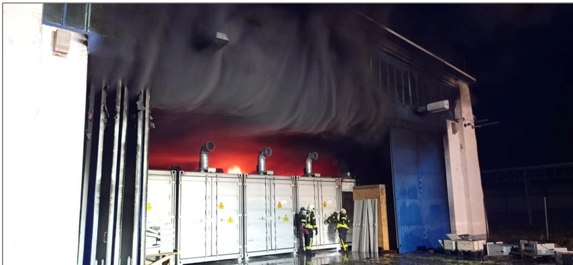
Abbildung 1: Brand eines Batteriegroßspeichers in Neuhardenburg [Kreisfeuerwehrverband Märkisch-Oderland e.V. (2021). Brand in einer Batteriespeicheranlage in Neuhardenburg, https://kfv-mol.de/WordPress/Artikel/brand-einer-batteriespeicheranlage-in-neuhardenburg/ , zuletzt aufgerufen am 21.04.2023]; mit freundlicher Genehmigung des Kreisfeuerwehrverbandes Märkisch-Oderland.
